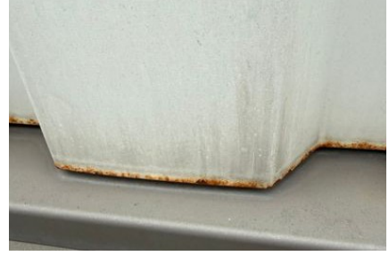
Schadbild: Korrosion an der Unterkante eines Trapezblechs
